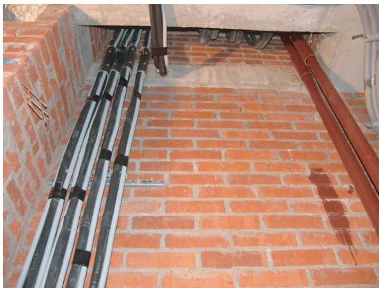
Магистральные участки фреоновых трубопроводов в вертикальных шахтах.
